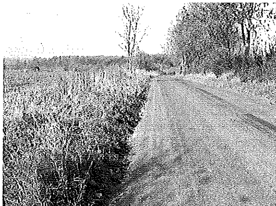
Droga nr 0026Z – zarośnięte pobocza, krawędź jezdni nierówna.
