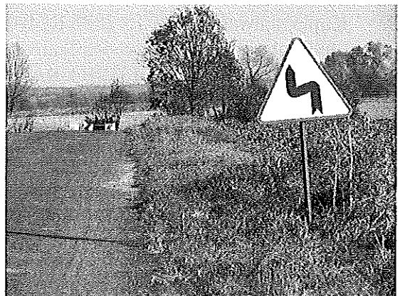
Droga nr 0026Z – znak A-4 zamontowany za nisko, krawędź jezdni nierówna.
