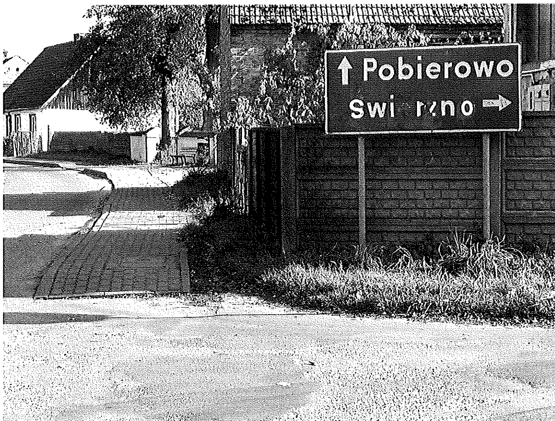
Droga nr 0031Z w m. Gostyń – tablica drogowaskazowa E-2a nie wymieniona, pomimo wskazania w poprzednim protokole.
