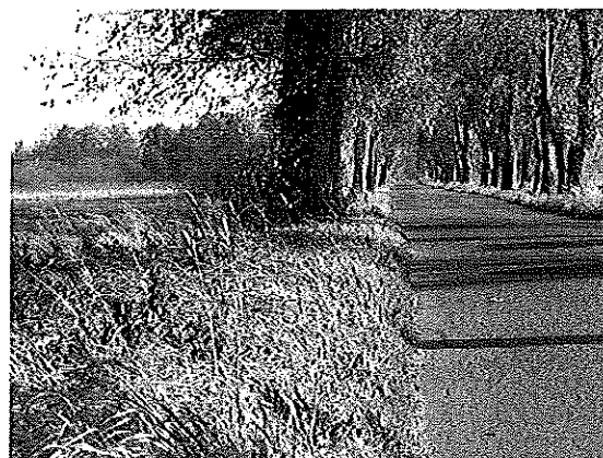
Droga nr 0100Z – zarośnięte i zawyżone pobocza
