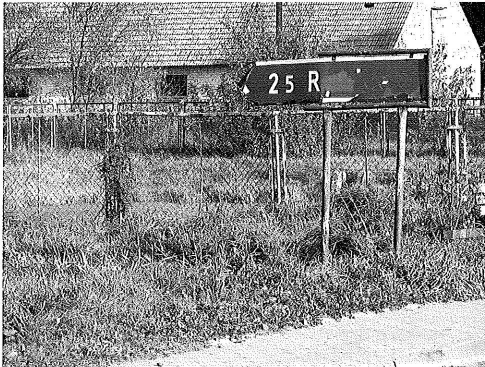
Skrzyżowanie dróg nr 0100Z i 0023Z w m. Gostyń – znak E-4 nie wymieniony pomimo wskazania w poprzednim protokole, znak zniszczony, nieczytelny, niezgodny z obowiązującym rozporządzeniem i osadzony za nisko.
