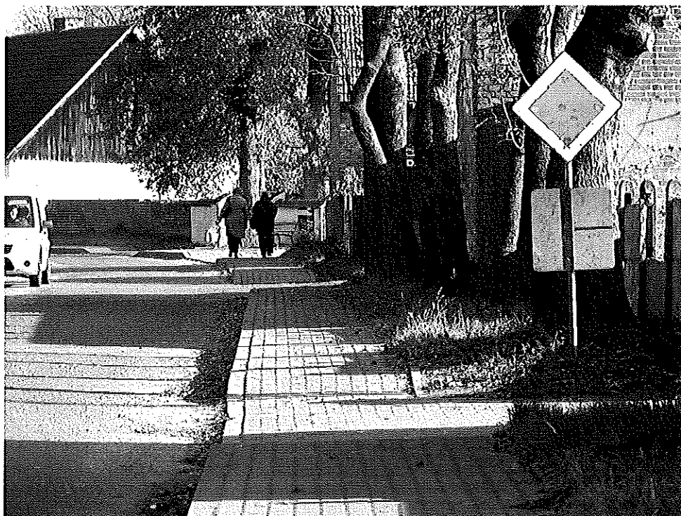
Droga nr 0023Z w m. Gostyń – zniszczony znak D1 z tabliczką T-6 do wymiany i umieszczenia na właściwej wysokości.
