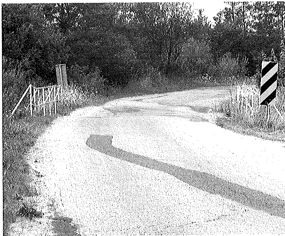
0012 Z Dusin – z prawej solidna dziura, nawierzchnia w złym stanie, mocno pozapadana, brak znaku A-11 nierówna droga,
